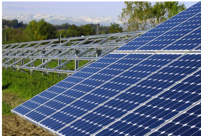
Stahl-Konstruktion für PV-Anlagen
