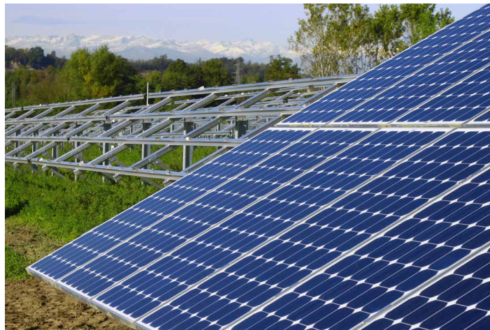
Construction en acier pour les panneaux photovoltaïques
