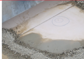
1 1. Leckstelle lokalisieren 2. QF dammartig aufschütten
